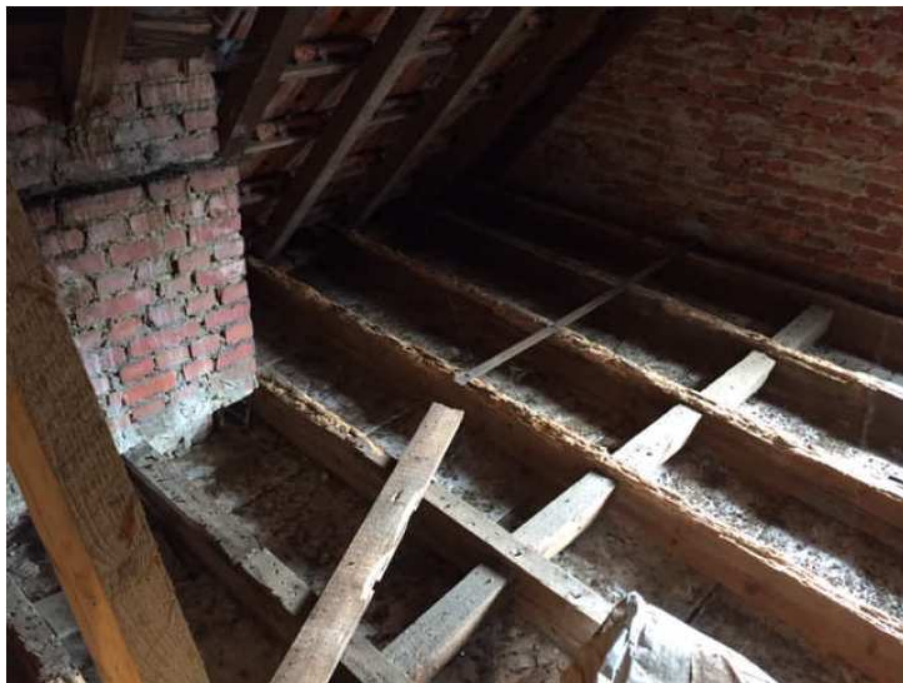
zolder : aantasting van houten vloerbalken.
