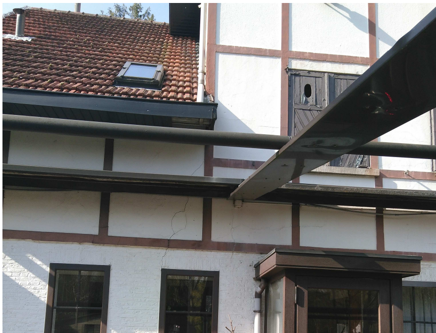
zettingsscheuren tgv. de toegevoegde 3 e bouwlaag.
