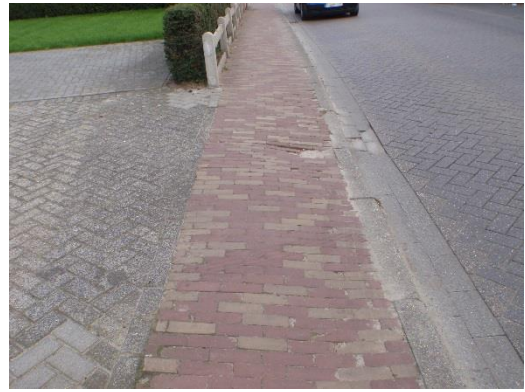
Figuur 46: Verzakking verharding en schuine afloop
