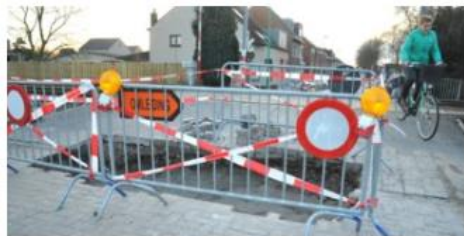
Nog tot 29 januari omleiding door verzakte riolering
